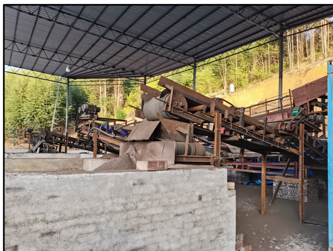
技改项目筛分破碎生产线
