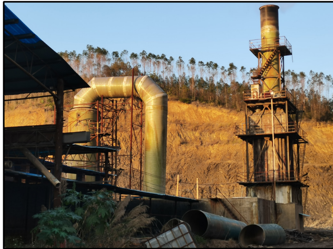
现有工程脱硫除尘系统
